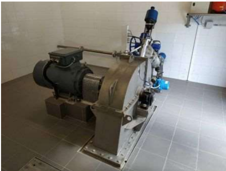
La chaufferie biomasse alimente tous les bâtiments communaux © Anne-Sophie Tassart
