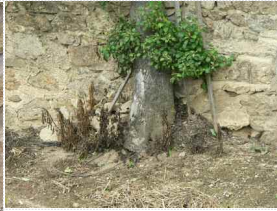
Désherbage chimique au pied de la poirière : il laisse une terre à nue qui favorise le ruissellement rapide des eaux de pluie, facilite l'érosion et ici, le déchaussement du mur.
