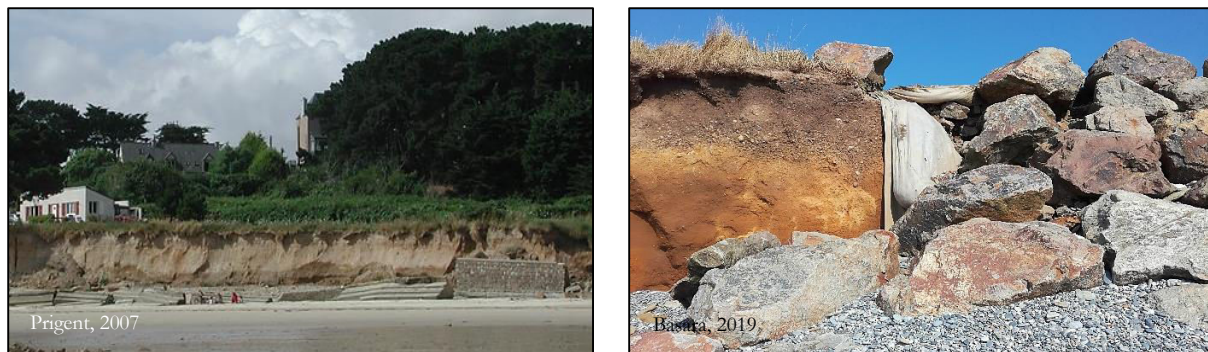
Fig. 242 : Ouvrages de défense contre la mer endommagés suite au recul en arrière des falaises meubles par les eaux de ruissellement et d'infiltration. Photo de gauche : mur de protection effondré à Plougrescant (2007). Photo de droite : glissement des blocs de Penrochement à Plovan et mise à nu du géotextile (2019).
