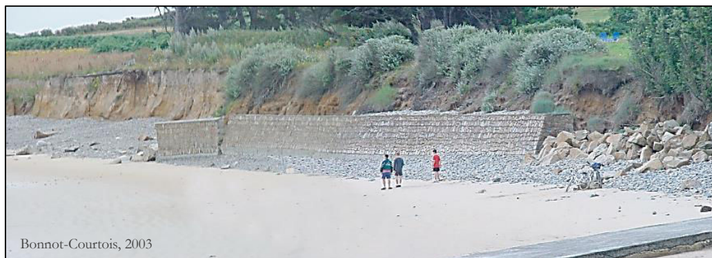
Fig. 116 : Destruction du mur de soutènement à Pors-Hir (29/07/2003).
