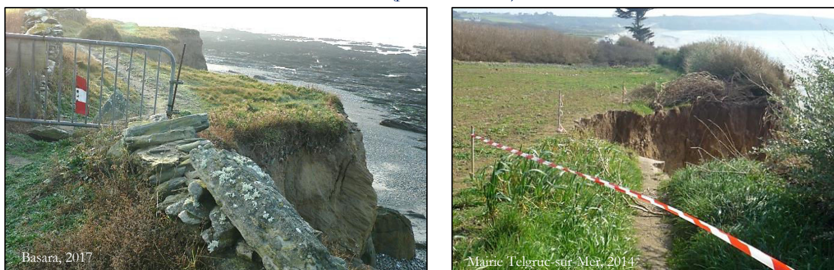
Fig. 249 : Balisage des zones devenues dangereuses pour les promeneurs à Plozévet (photo de gauche) et à Telgruc-sur-Mer (photo de droite).
