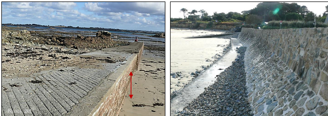
A : Grande cale de mise à l'eau (la flèche montre la différence d'altitude de la plage entre le flanc sud et le flanc nord de la cale) ; B : Perré surmonté d'un parapet.
