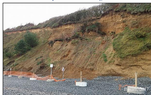
Filet installé en pied de falaise devant un glissement récent et panneau d'avertissement (Plérin, 22)
