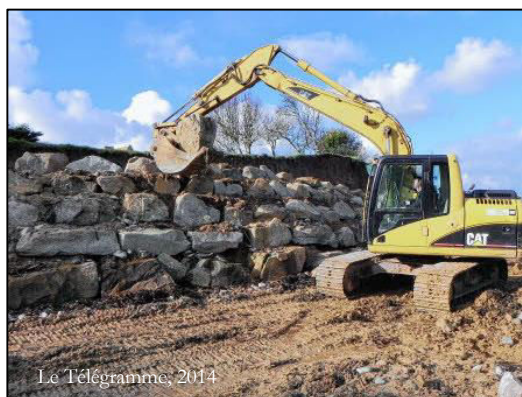
Fig. 237 : Enrochement d'urgence réalisé à Pors-Hir, à la veille des grandes marées du 2 février 2014.
