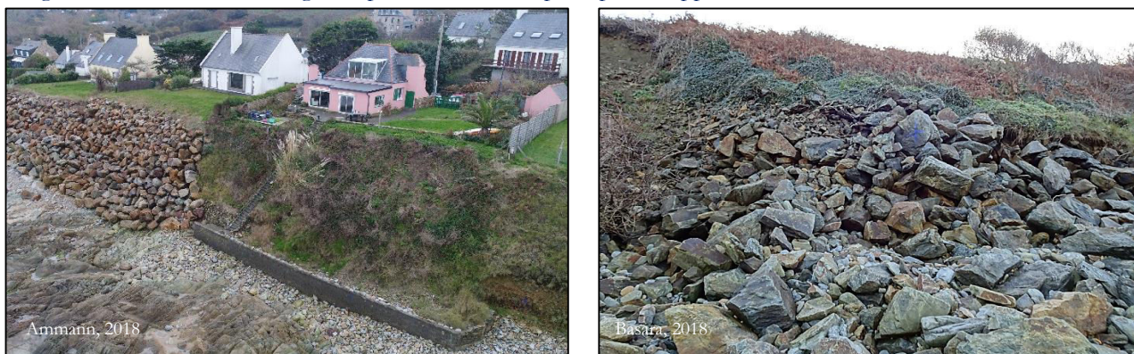
Enrochement et mur de protection dans le secteur 3 (vue prise depuis le NW)
