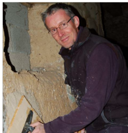
En pleine reconversion professionnelle, Olivier Boudin veut s'installer à Charancieu comme artisan spécialisé en pisé. Après l'application de l'enduit, il procède au talochage, afin de répartir et serrer la matière sur le support.
