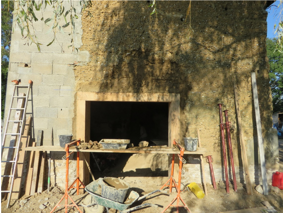
Figure 63. Chantier de Ruy Montceau. Septembre 2015. Rebouchages en terre crue autour de l'encadrement en bois posé au niveau d'une ouverture nouvellement créée.
