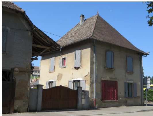
Figure 11. Le pisé apparaît sous un enduit en train de se décoller. Dolomieu. Juillet 2014.
