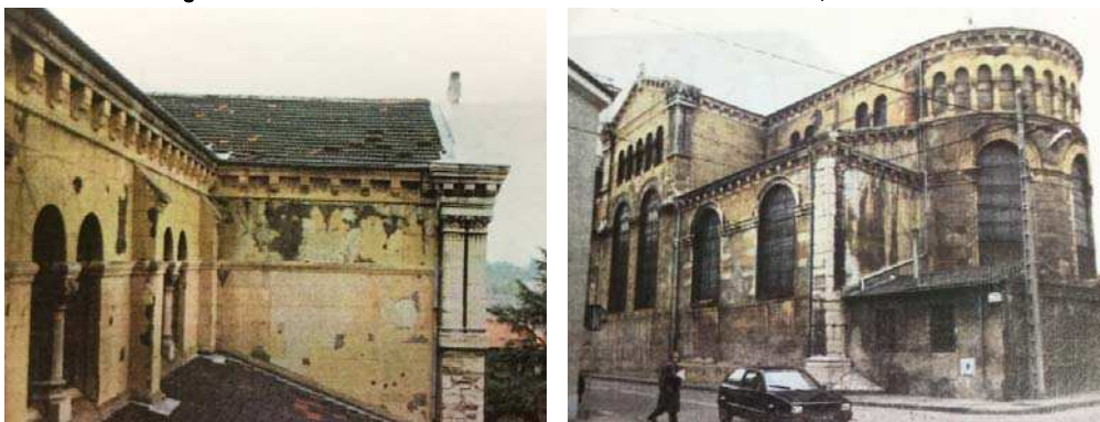
Figure 8.32 : Etat de l'église Saint-Nicolas avant les travaux de restauration, Givors.
