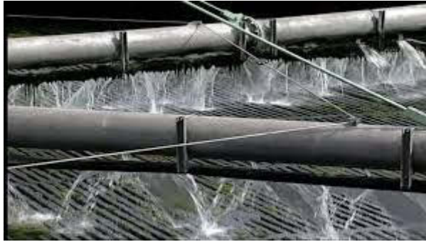
Figure I-9: Photo d'un lit bactérien arrosé par les eaux issues de traitement primaire.
