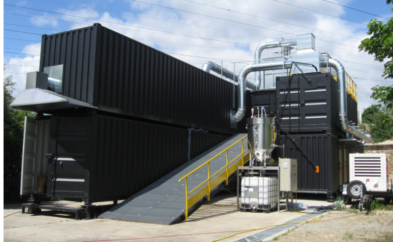
FIGURE 3 – Photographie de la structure dans laquelle le dispositif expérimental de la seconde campagne d'essai a été aménagé.
