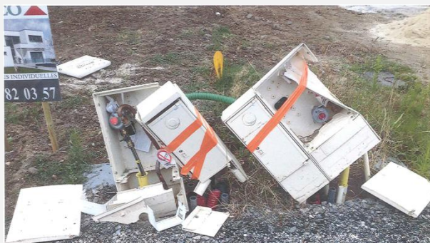
Figure 33 : Photo d'un coffret couché prise et remontée par le technicien.
