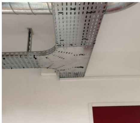
Figure 7-15. Pont thermique entre le local de GTC et la salle informatique
