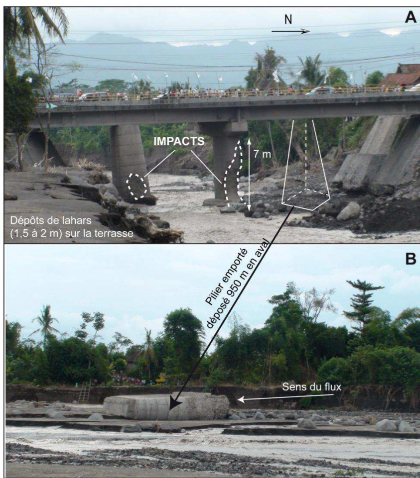
Figure 39 – L'endommagement des piles des ponts de Tamanagung après le lahar du 30 mars 2011.
