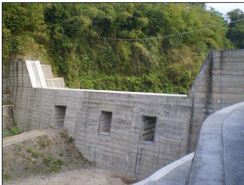
Figure 69 - Modèle de sabo-dam "ancienne" génération, à déversoirs de dimensions limitées. Ce sabo-dam, construit sur la rivière Gendol, au nord d'Argomulyo, a été entièrement recouvert par les dépôts pyroclastiques de novembre 2010. Cliché E. de Bélizal, août 2008.
