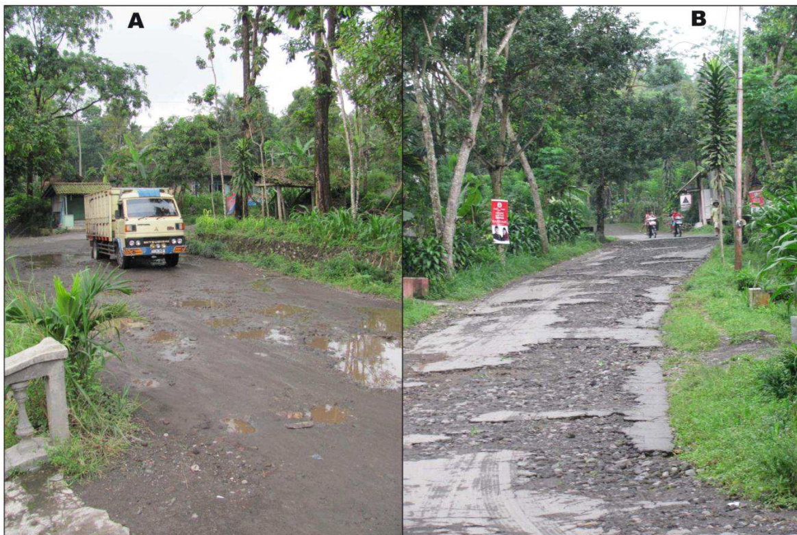
Figure 152 - Routes endommagées au débouché de la voie d'accès orientale de Jambu-Kaliadem.
