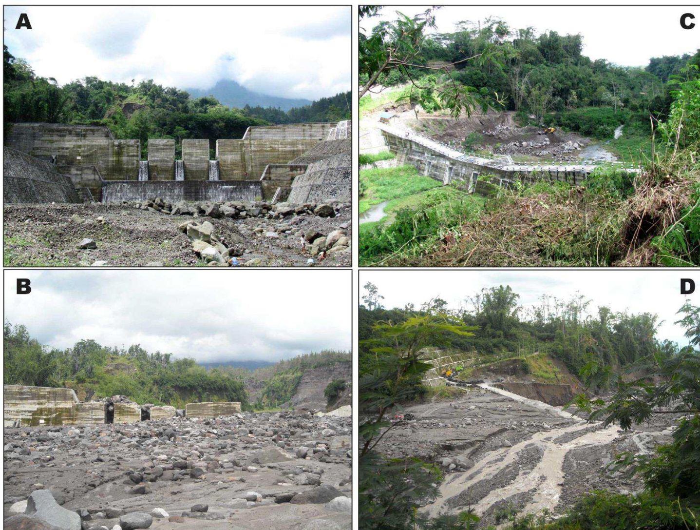
Figure 68 - Les infrastructures endommagées sur le talus proximal de la rivière Senowo.
