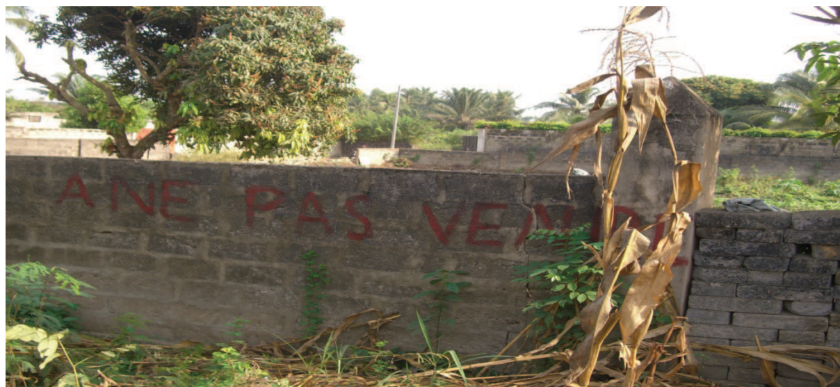
Photographie 51 : Une maison familiale abandonnée et interdite de vente
