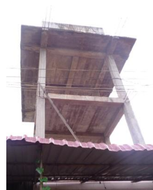
Photographie 60 : ... et l'acheminant vers un château d'eau privé
