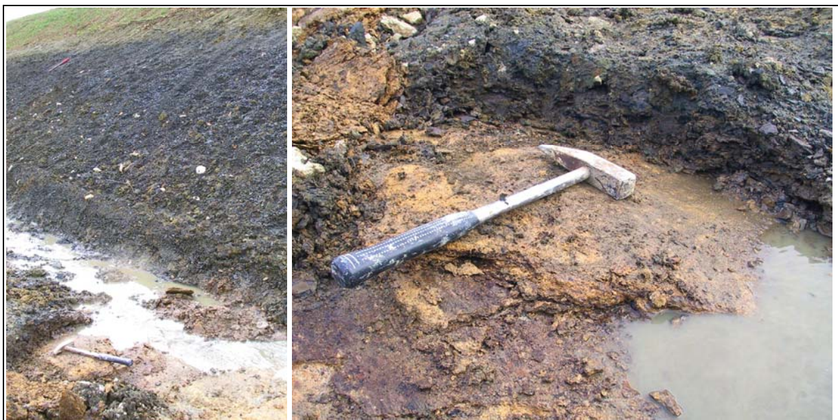
Figure 2.14. Coupe observée au lieu-dit de la Buzinie (talus ouest, travaux de la déviation des Chauvards, Champniers), montrant le faciès conglomératique à matrice argileuse de la sous-unité B2, oxydée à sa base au contact de B1 (marteau).
