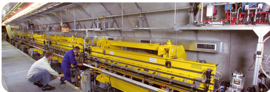
FIGURE 2.11 – Vue de l'ensemble des modules de l'onduleur de FLASH dans le tunnel de fonctionnement. Image tirée de (Schneider et al., 2007).
