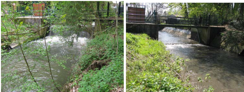
FIGURE 2.9 – Clapet Souchard avant et après effacement (vue vers l’amont)
