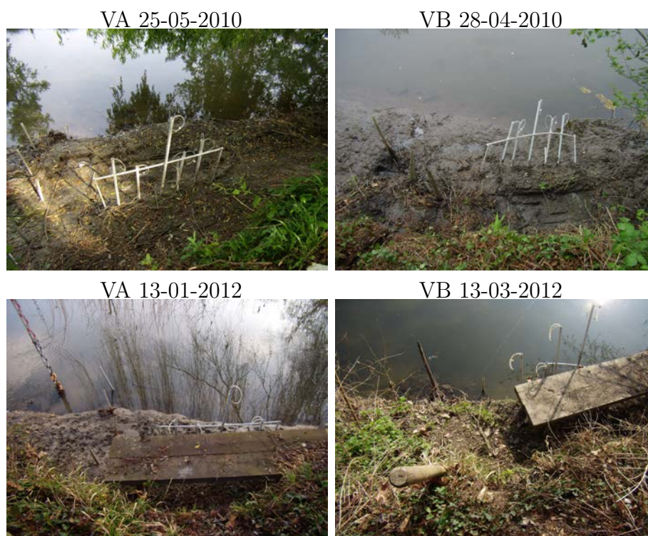
FIGURE 3.18 – Érosion des banquettes VA et VB entre 2010 et 2012
