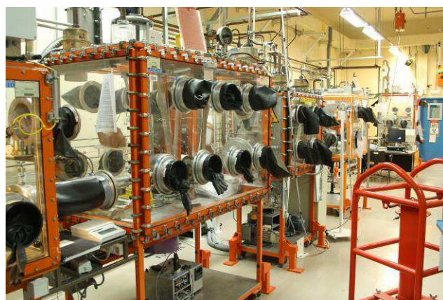
Figure 37 : Exemple de boîtes-à-gants à l'INB 123, assurant la première barrière de confinement de la matière
