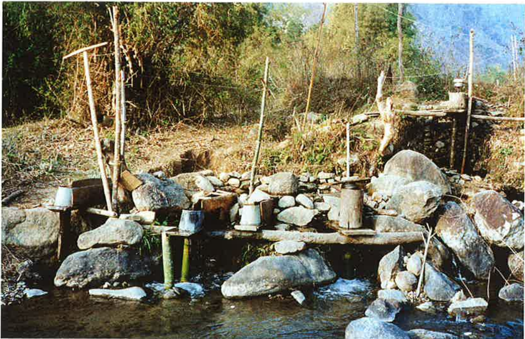
Photo 4 : Turbines électriques chinoises sur le torrent
