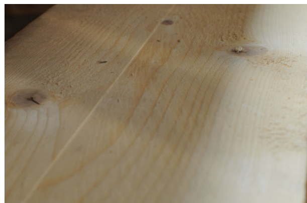
(b) État de surface.
