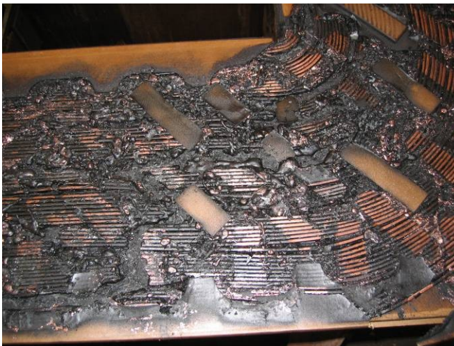
Figure 28 : Court-circuit entre spires
