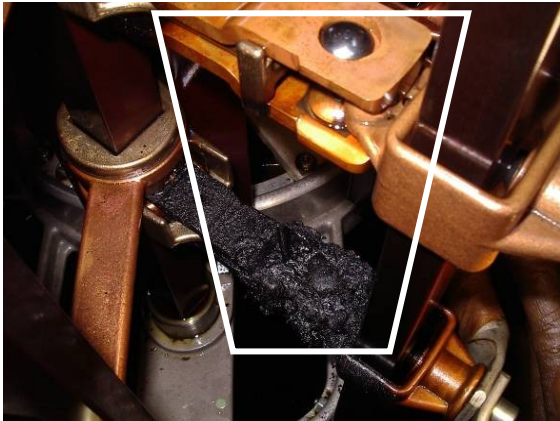
Figure 31 : Point chaud sur le sélecteur d'un régleur en charge
