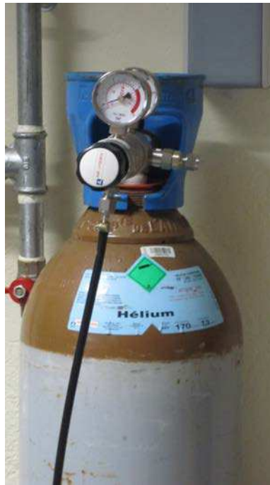
FIGURE 2.5 – Le réservoir d'hélium sous pression et son détendeur.
