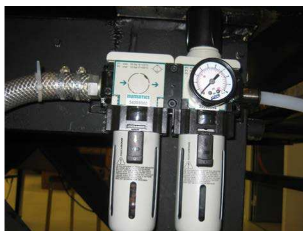
FIGURE 2.6 – Le dispositif de filtrage/régulation de l'alimentation en gaz.
