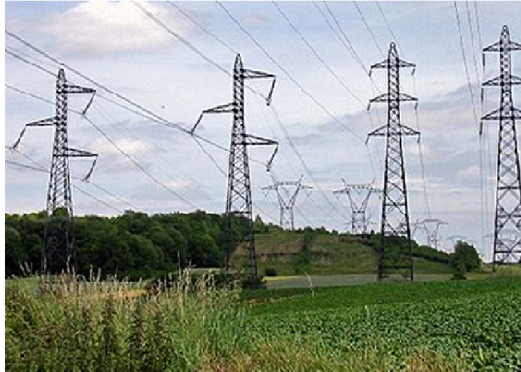
Fig. 3: Lignes électriques sur pylônes métalliques
