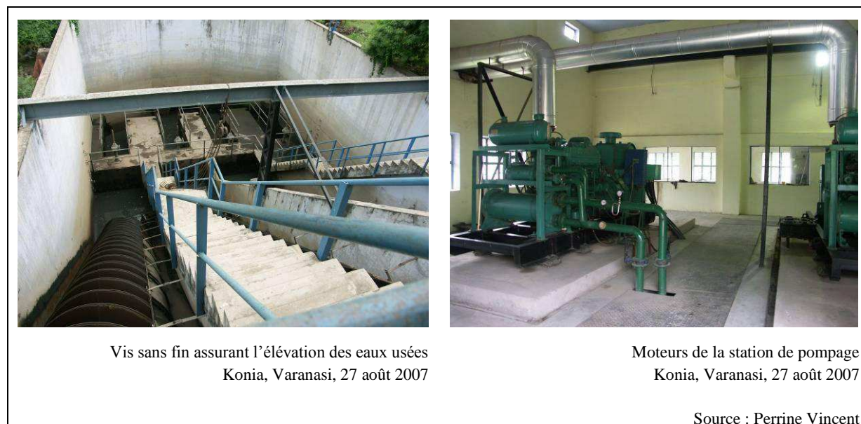
Photographie 19 – station de pompage principale
