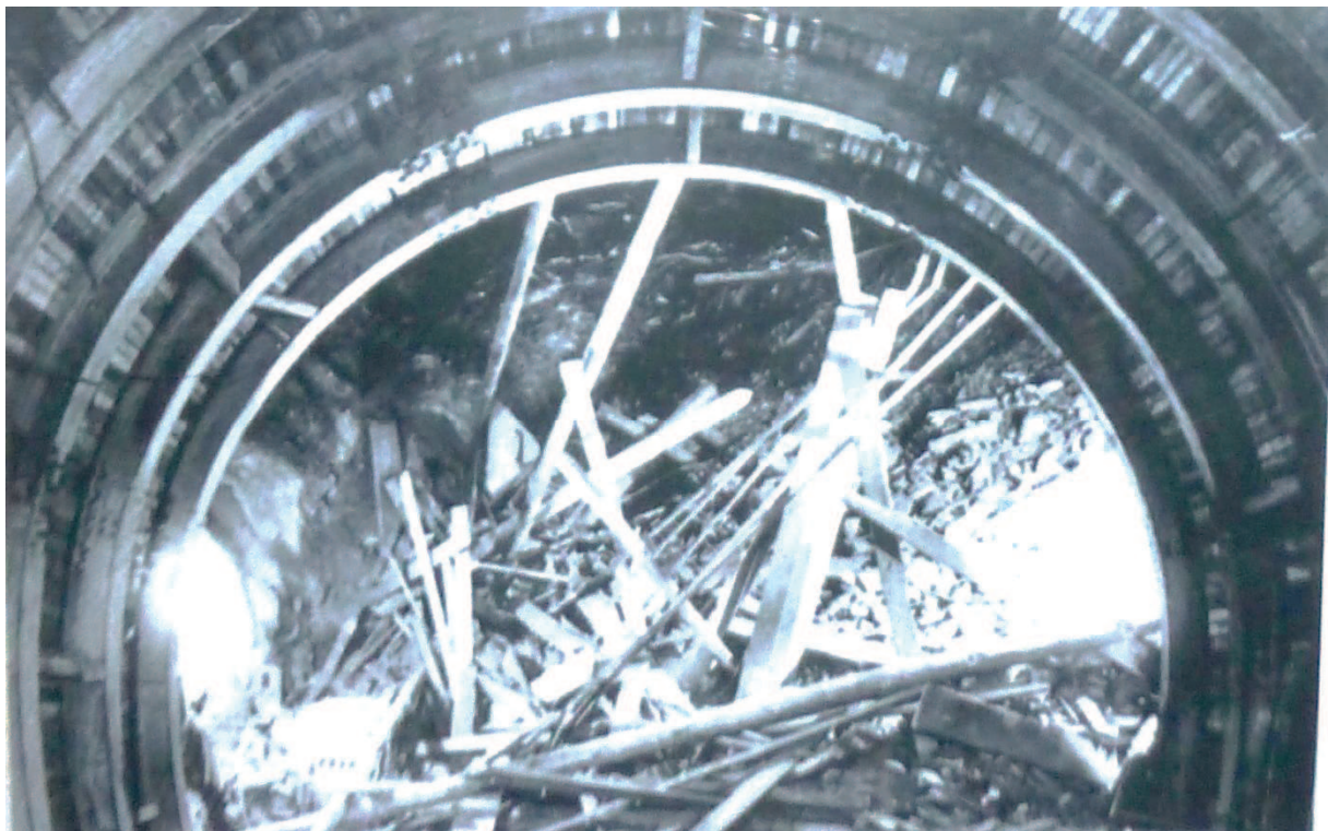
Photographie 5. Armature en bois utilisée pour consolider le tunnel du Mont-Cenis au fur et à mesure de l'avancée (collection du Museo forte Bramafam à Bardonnèche).
