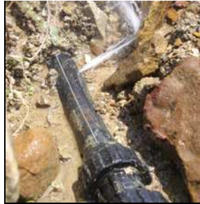
Fuite d'une adduction d'eau
