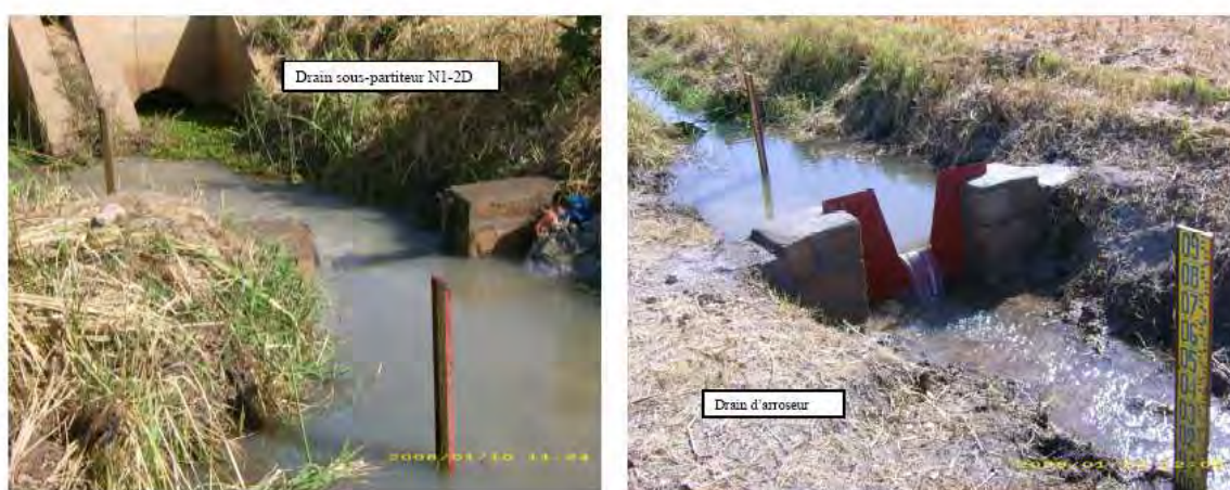
Figure 4- 2 : Drains de sous-partiteur et d'arroseur équipés de déversoirs de type Cipoletti et d'échelles limnimétriques.
