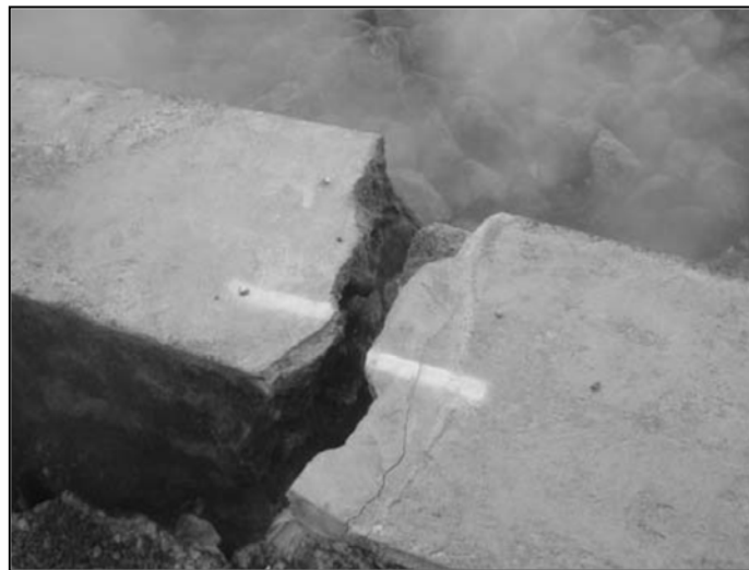
Figure 4-20: Fissure du muret de la route des laves au Sud de la coulée d'avril 2007.
