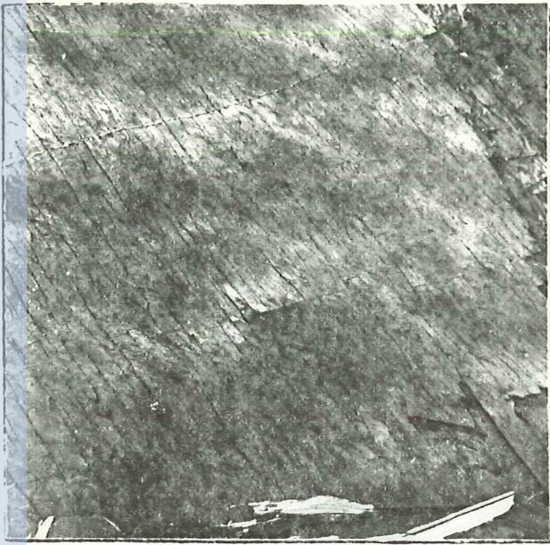
FRACTURES EN RESEAU
