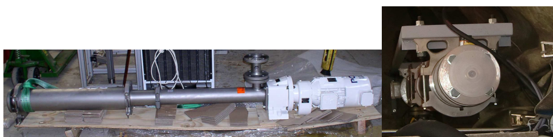
Figure 4.18 – Pompe moineau PCM modèle 13H24 avant et après installation.
