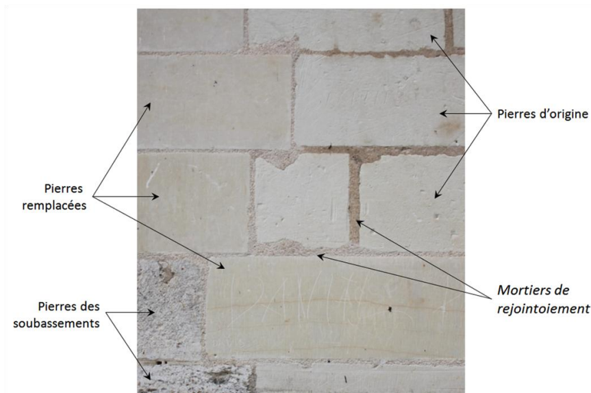
FIGURE 6 : EXEMPLE DE DIFFERENCIE DE FACIES ENTRE PIERRES D'ORIGINE, PIERRES REMPLACEES ET PIERRES DES SOUBASSEMENTS, ET EXEMPLE DE JUXTAPOSITION DE MORTIERS DE REJOINTOIEMENT DIFFERENTS - AILE SUD
