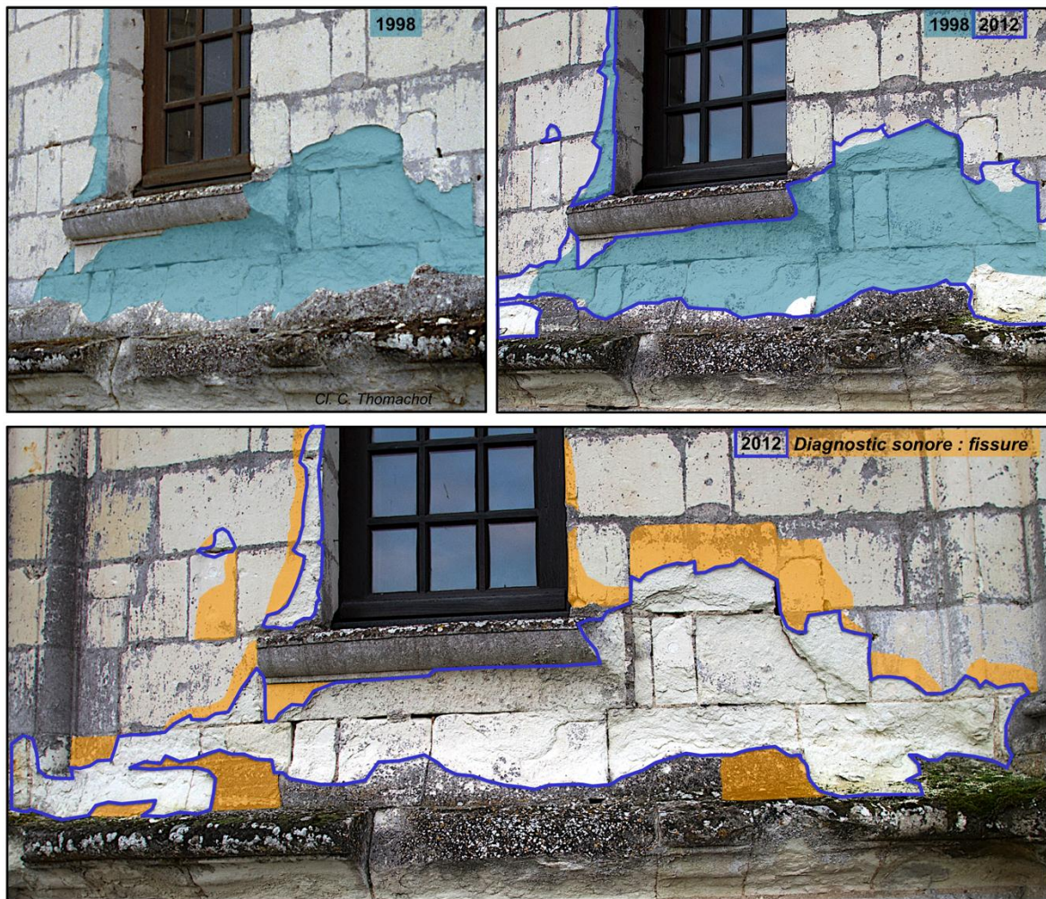
FIGURE 67 : DESQUAMATION EN PLAQUES SUR LA TOUR DU CHAUDRON
