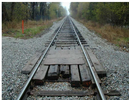
Photo. 5 Zone de croisement dégradée
