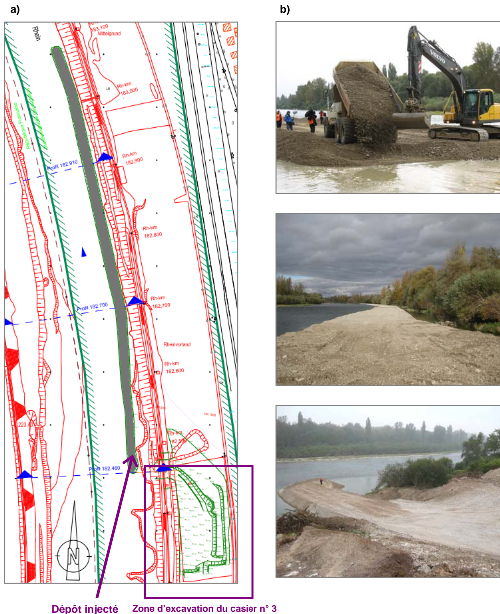
Figure 3.6 : a) Extrait du plan de recollement de Vinci Construction indiquant la position du dépôt injecté (04/11/10). Les sédiments ont été introduits entre les PK 182,46 et 183,08. b) Vues du chantier (clichés F. Arnaud, 2010)
