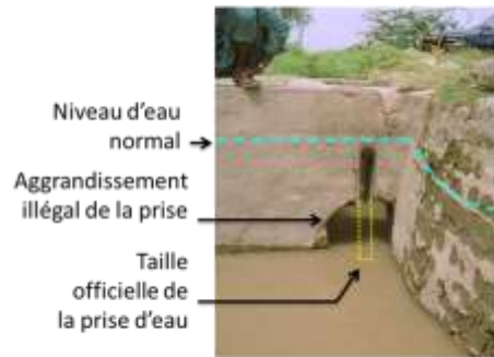
Figure 5 : Prise d'eau illégalement modifiée
