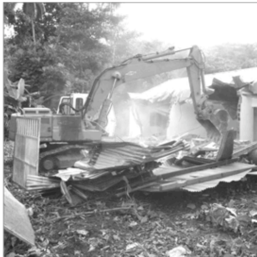
En quelques minutes, les maisons de M'tsagnougni se sont transformées en gravats.
