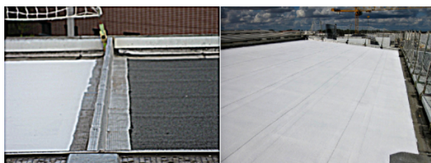
FIGURE 2.32 – Exemple de toit recouvert d'une peinture réflective (source : [Bozonnet et al. , 2011])
