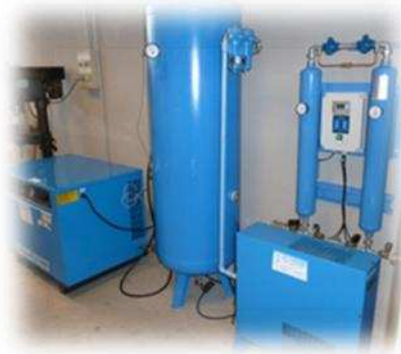
e) Compresseur d'air et circuits de séchage.
