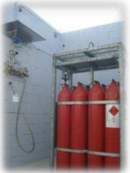
c) Zone de stockage H_2
