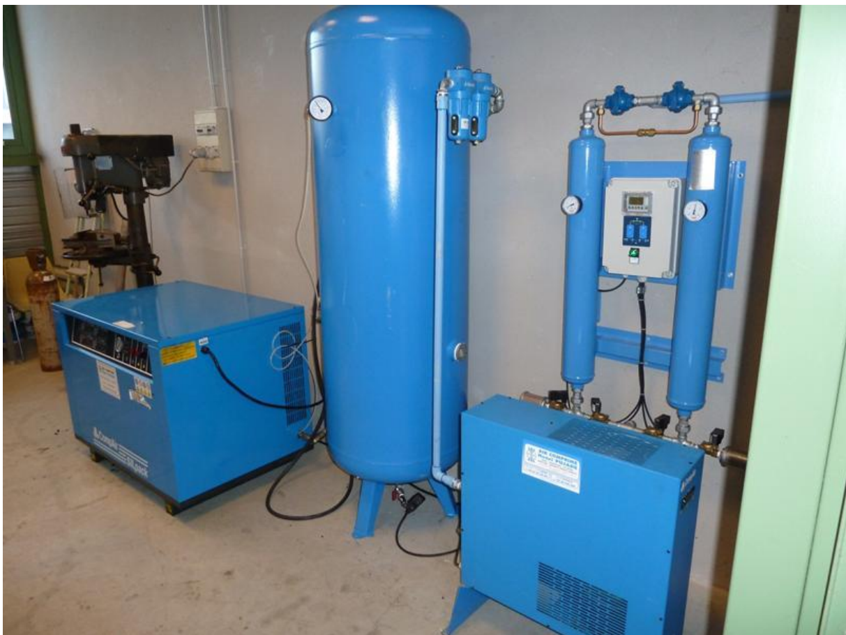
Figure V-30 : Compresseur d'air et son système de purification
