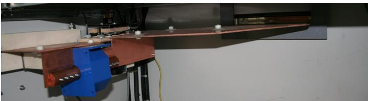
Figure V-10 : Bus barre du banc Forte Puissance « FP »
