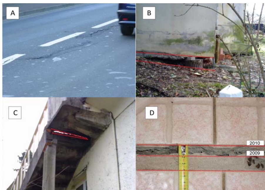
(A) Route départementale 513 en 2009, (B) Villa proche du Clos Tainfray en 2009, (C) Villa du Clos St Thérèse en 2009, (D) Villa du Clos Marin en 2010.
