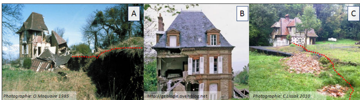
Figure 1-3. Aperçu des dommages structurels provoqués lors de l'accélération 1982 sur la villa Chanteclair (A), de l'accélération 1982 sur la villa Cheval de Brique 1982 (B), et de l'accélération de 1995 sur la propriété du Pré de l'Aumône (C) (localisation des villas sur la figure 2-19).
