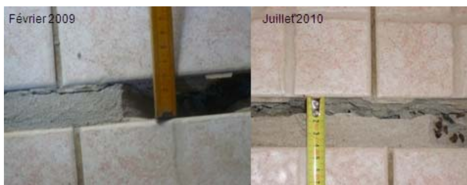
Figure 5-10. Fracture mesurée à la ville du Clos Marin en 2009 et 2010.
