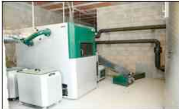
Photo 123 – Chaudière biomasse du CTFC
