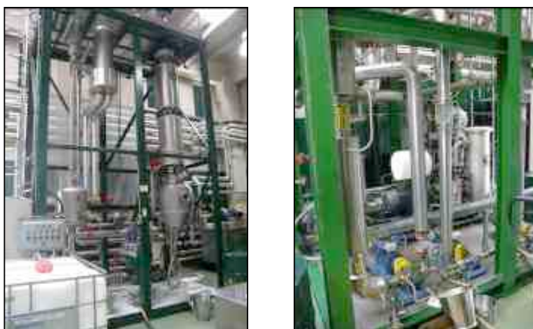
Photos 152 et 153 – Installations modernes de CAPUA 1880 © 2009 RM
