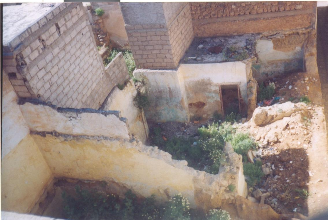
Figure 1.6 – Résultat d’un effondrement
