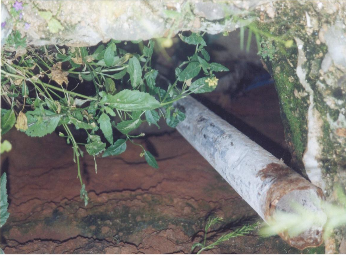
Figure 1.5 – Fuite du réseau d’eaux pluviales
