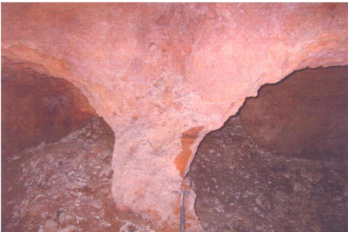
Figure 1.3 – Détail d’un pilier de carrière dégradé
