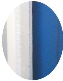
Figure IV. 6 Détail des trois matériaux composant la paroi du local technique (métal, lame d'air, polystyrène).
