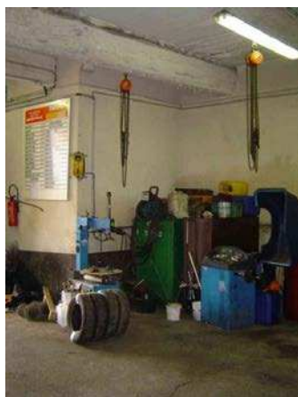
Illustration 12: Quartier du Faubourg. Palans pour suspendre des équipements lors d'inondation.
