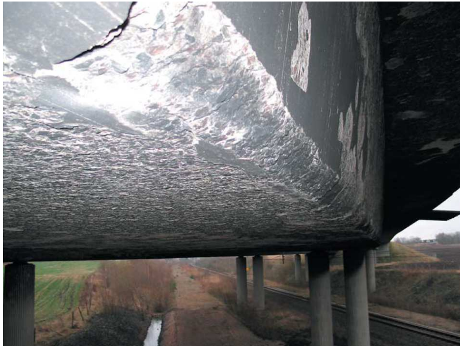
FIGURE 1.2: Ecaillage du béton de la face inférieure d'une poutre d'un pont à Falkenberg [Boström 06b]
