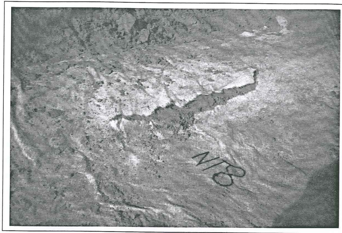
Photo B - 10 : Déchirure de la nappe NT8 au niveau de la face amont de la dalle extérieure
