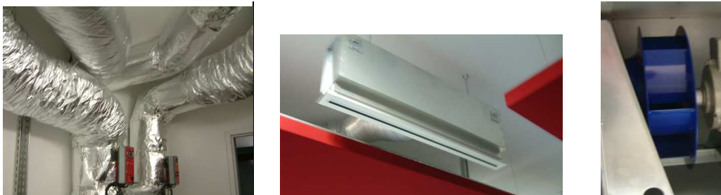
Figure 49. Des composants du circuit aéraulique de PREDIS
