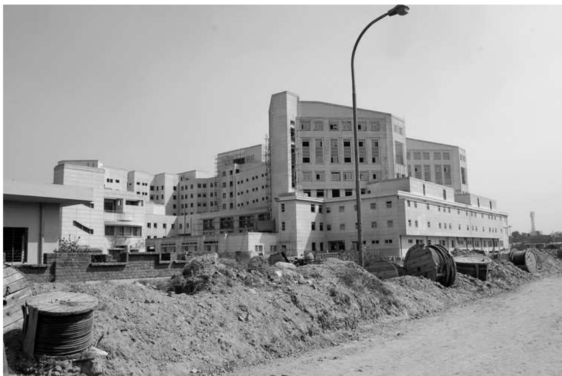
Illustration 14: L'hôpital de Tahirpur en 2009 près de 15 ans après l'inauguration du chantier (sources : PWD)
