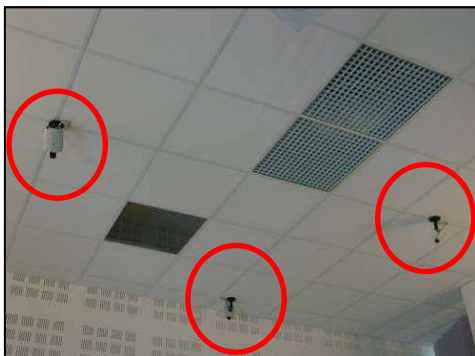
Figure 25 : Offsats au plafond
