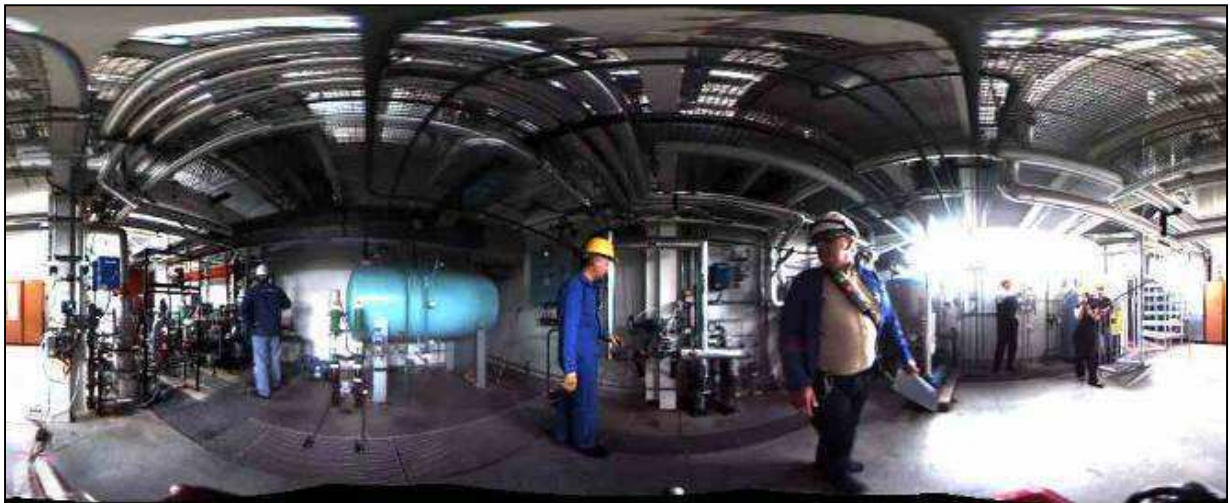
Figure 23 : Vue à 360° de la mini-centrale du centre de formation du Bugey
