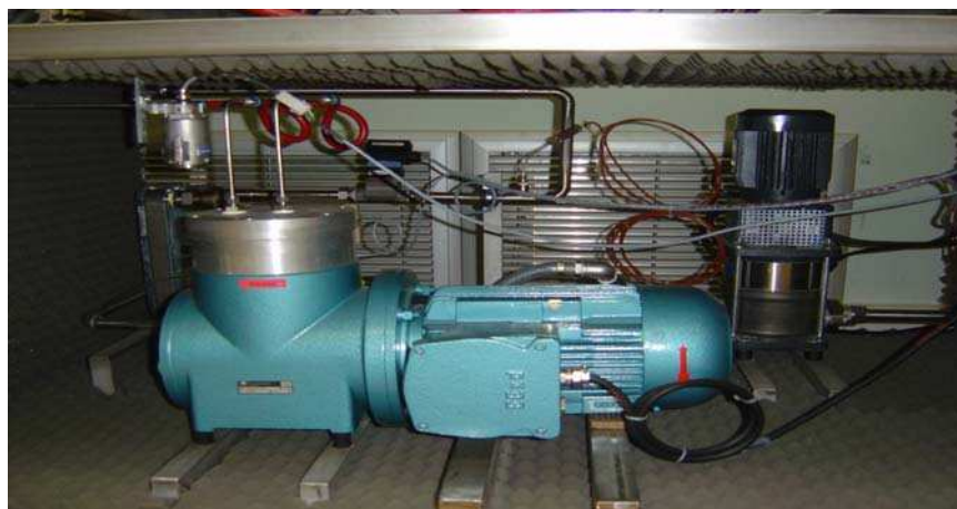
Figure B 5: Compresseur de recirculation
