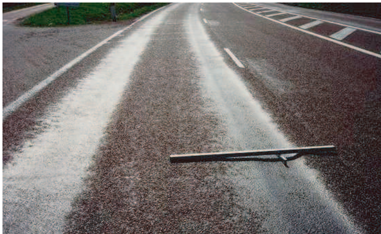
Fig 1.23 – Photographie d'une ornière sur la chaussée
