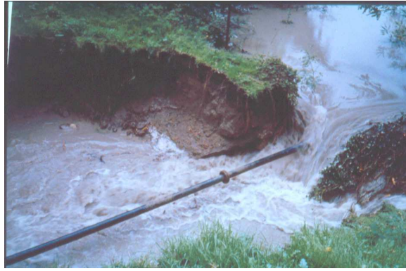
Figure 5.6. Renard autour d'une canalisation traversant la digue
