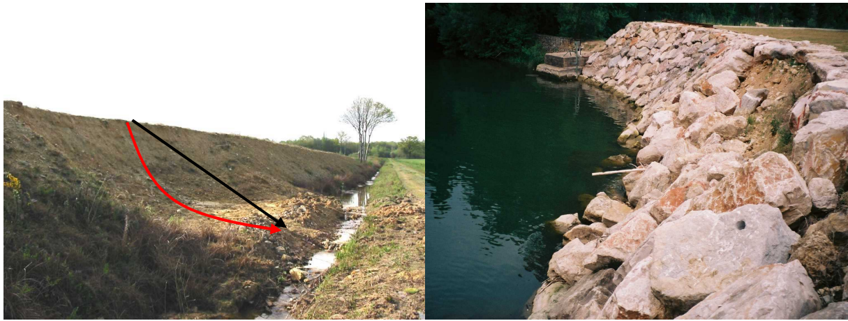
Figure 5.11. Glissements côté val en crue (photo à gauche) puis côté fleuve à la décrue (photo à droite)
