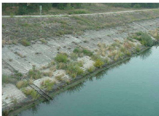
Figure 2.1. Digue de navigation du Rhône en charge en permanence (Perrier et al., 2004)
