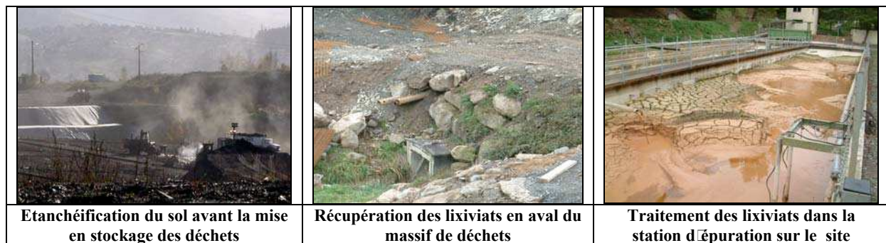
Figure 6. Récupération et traitement des lixiviats
