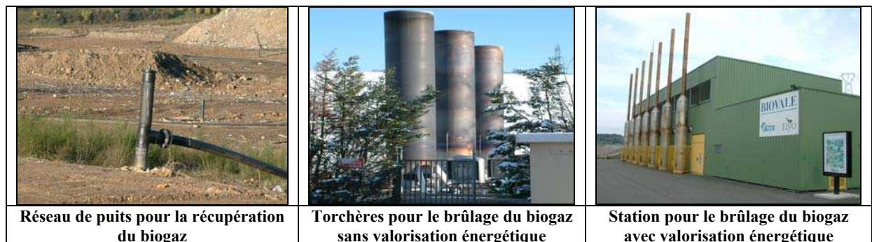
Figure 7. Récupération et brûlage du biogaz
